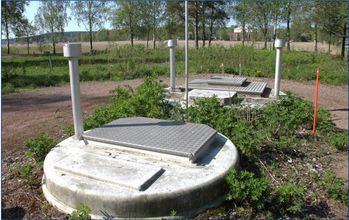
Kuva 7.3.2-1. Mannerheiminkadun ja Saaristotien risteyksen jätevedenpumppaamo. (Kuva: FCG Suunnittelu ja tekniikka Oy, pvm. 23.5.2014).
