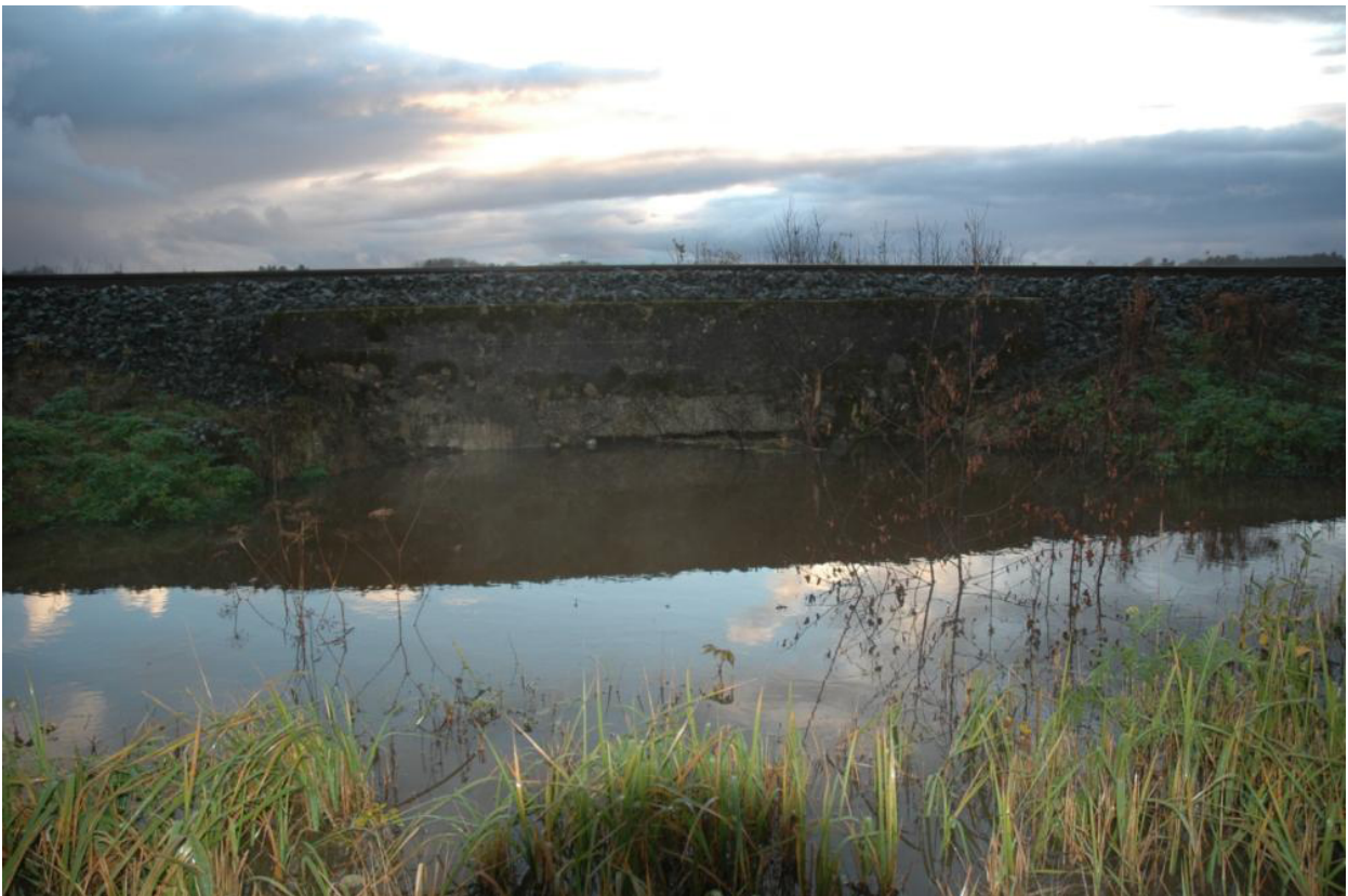
Kuva 27. Syksyn 2012 tulvassa Kyrönjoen tulvavedet pääsivät vain hitaasti purkautumaan Laihianjoen puolelle rautatien alitse. Kuvassa näkyy rautatien alittava rumpu Kyrönjoen ja Laihianjoen välisellä bifurkaatioalueella. (Kuva: Kim Klemola).
