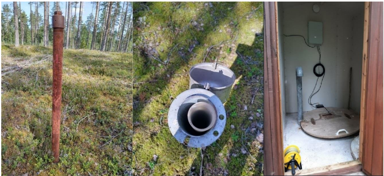
Kuva 7-2 Vasemmassa kuvassa on rautaputki. Keskimmäisessä kuvassa on muoviputki, jonka ympärillä on suojaputki. Oikeassa reunassa on pohjavesikaivo kopin sisällä.
