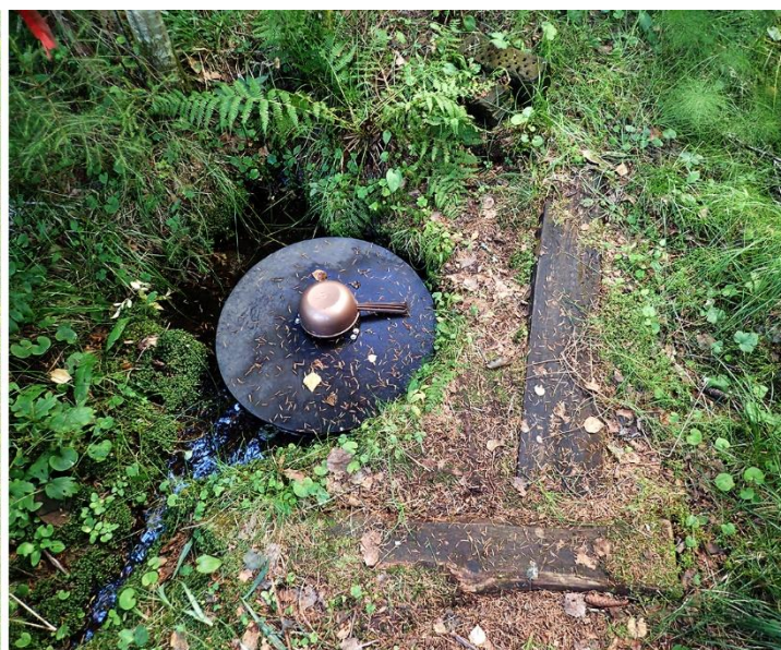
Kuva 70. Betonirenkaan sisään purkautuu pohjavettä ja renkaiden välistä syntyy ylivuotoa ympäristöön. Lähteisyys ilmenee kaivon ympärillä hyvin kapeaalaisesti, sillä lähteen viereen on kasattu ja tiivistetty hirsillä vahvistettua maata ja ylivuoto on ohjattu perattuun lasku-uomaan. Kohteella voisi olla ennallistamistarve, mutta antoisuus on melko vaatimaton.
