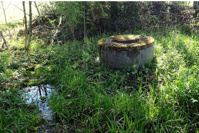
Kuva 72. Lähdekaivoa ympäröi hetteinen lähteikkö. Betonirenkaan sisälle purkautuu pohjavettä, mutta aivan kaivon välittömässä läheisyydessä ei ilmene lähteisyyttä. Syy piilee kaivon ympärille kasatussa ja tiivistetyssä maavallissa. Maavalli ja kaivorakenteet ovat muuttaneet lähteikön rakennepiirteitä ja vesitaloutta, minkä seurauksena lähteinen pinta-ala on supistunut. Lähteiköllä on ennallistamistarve.
