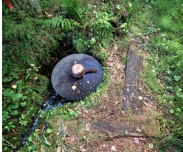
Kuva 70. Betonirenkaan sisään purkautuu pohjavettä ja renkaiden välistä syntyy ylivuotoa ympäristöön. Lähteisyys ilmenee kaivon ympärillä hyvin kapea-alaisesti, sillä lähteen viereen on kasattu ja tiivistetty hirsillä vahvistettua maata ja ylivuoto on ohjattu perattuun lasku-uomaan. Kohteella voisi olla ennallistamistarve, mutta antoisuus on melko vaatimaton.
