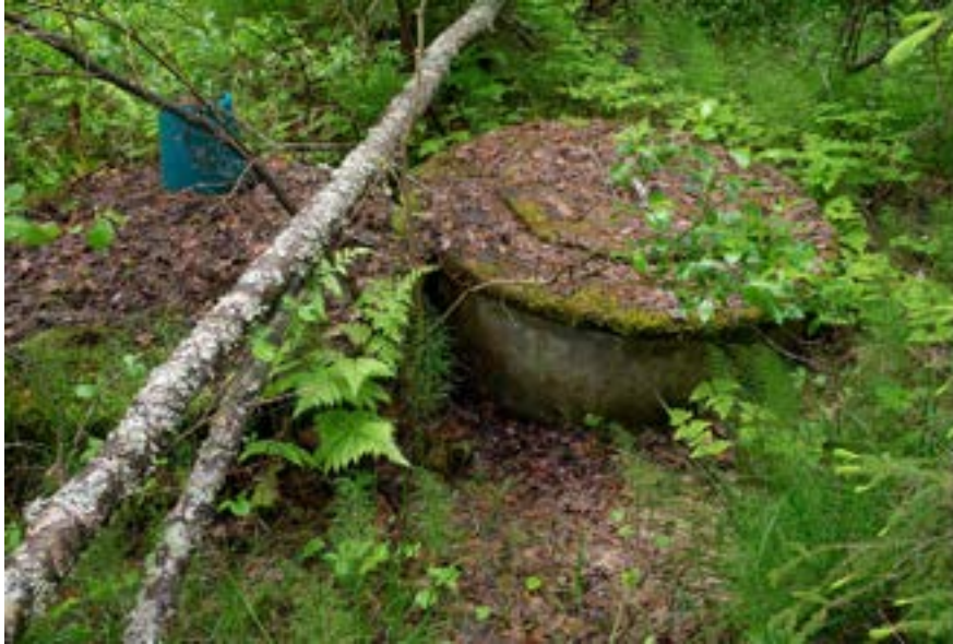
Kuva 69. Betonirenkaan sisällä on lämpötilan perusteella pintavettä, eikä kaivon välittömässä ympäristössä ilmene lähteisyyttä. Sen sijaan ympäristön metsätalousojassa on pohjaveden purkauspiste. Ojitus ja uuden purkauspisteen syntyminen on voinut edesauttaa lähteen tuhoutumista, mutta kaivorenkaiden paikalla ei välttämättä ole alun perinkään ollut kovin antoisaa lähteikköä.
