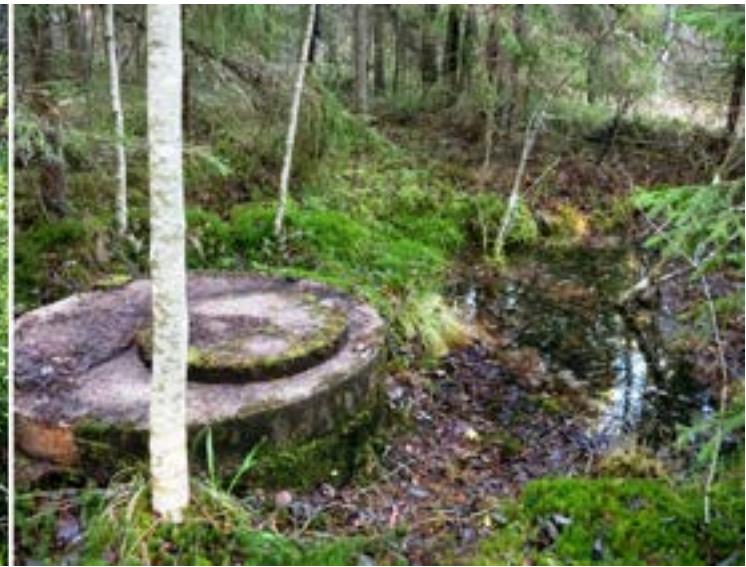
Kuva 73. Lähdekaivosta syntyy lähdeveden ylivuotoa, joka tiikuu hitaasti betonirenkaiden välistä ja suotautuu allikon ja kaivon välissä olevan maavallin läpi. Kaivo peittää lähes puolet allikon pinta-alasta ja rakenteet ovat hidastaneet veden virtausta purkauspaikasta niin paljon, että allikko on seisovavetinen (vertaa kuva 76). Lähteellä on ennallistamistarve.
